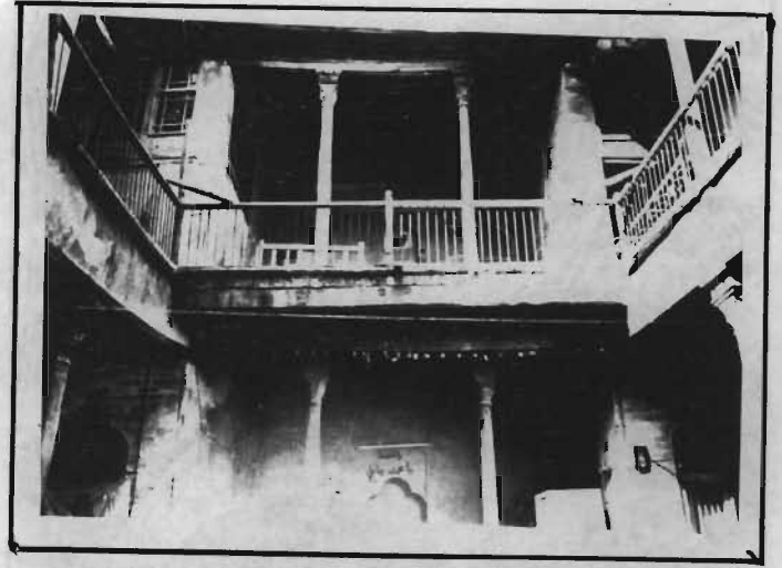
شكل (٢٢) طارمتان لاحد البيوت احدها فوق الاخرى تطل مباشرة على الفناء المكشوفة .
